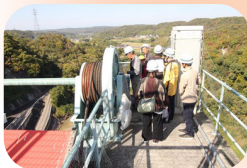
放水ゲート巻上機
