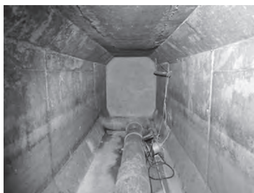
山田幹線水路閉塞（緑が丘南公園8号暗渠下流部）
